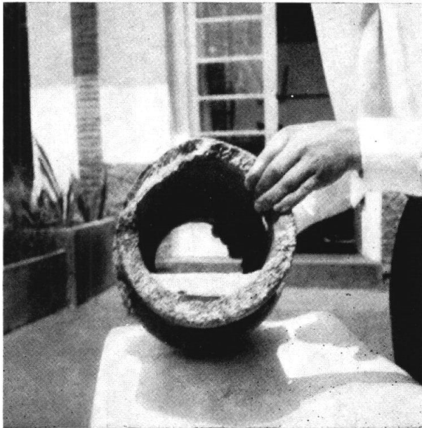
FIG. 4. — Nipple galvanisée de 1 1/4", rongée par l'eau non traitée, après une durée de service d'environ 18 mois.
