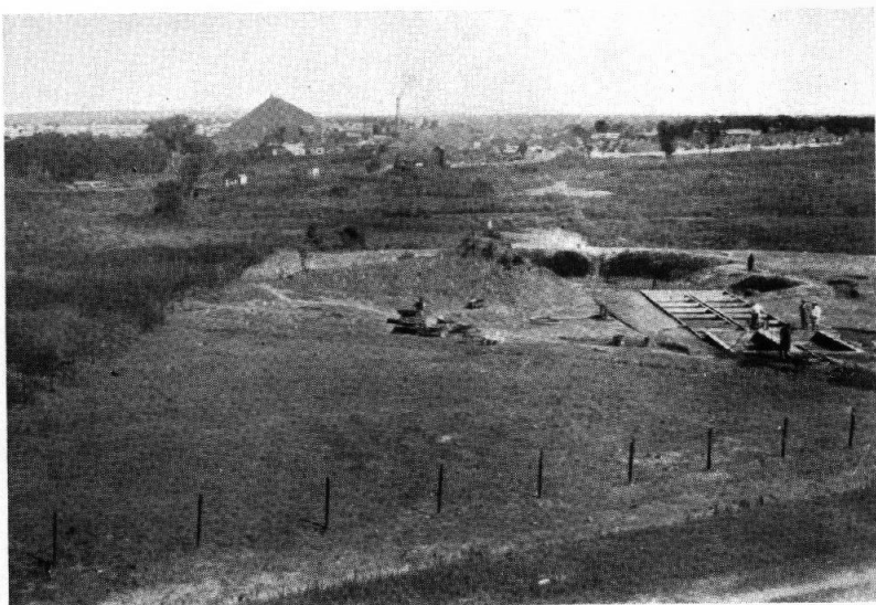
FIG. 8. — Vue d'ensemble d'une des deux stations d'épuration des eaux résiduaires d'Elisabethville (12 mai 1928).
